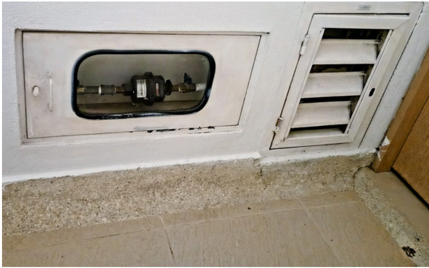
UBICADOS EN LA ENTRADA PRINCIPAL DEL APTO
